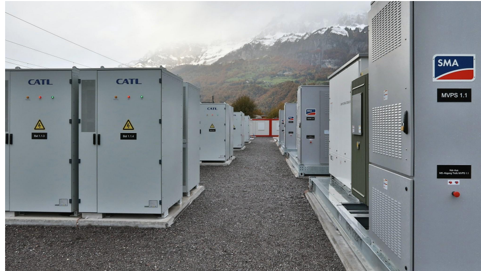
Batteriespeicheranlage in Österreich (Foto: Kecko auf Flickr, CC-BY-2.0 )
